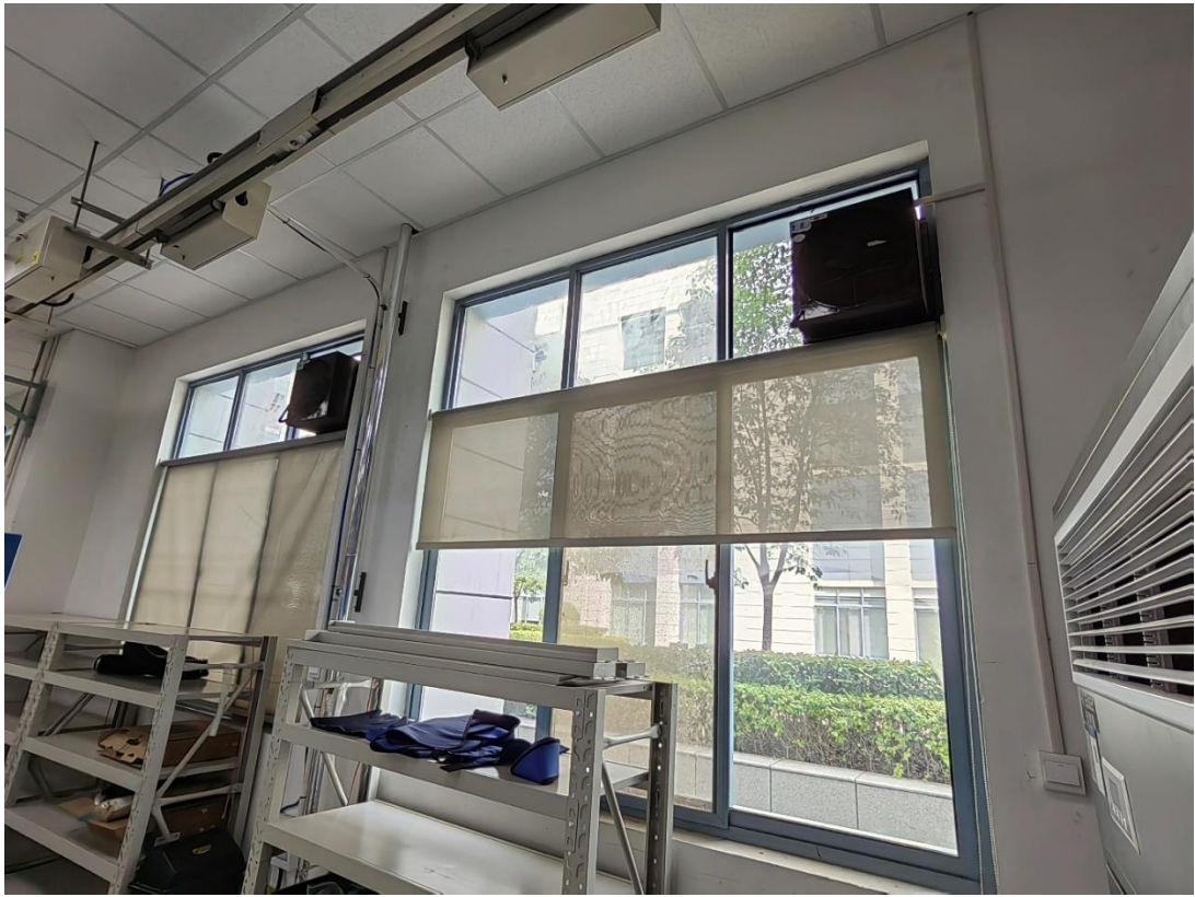
车间北侧通风装置（铅房北侧）
